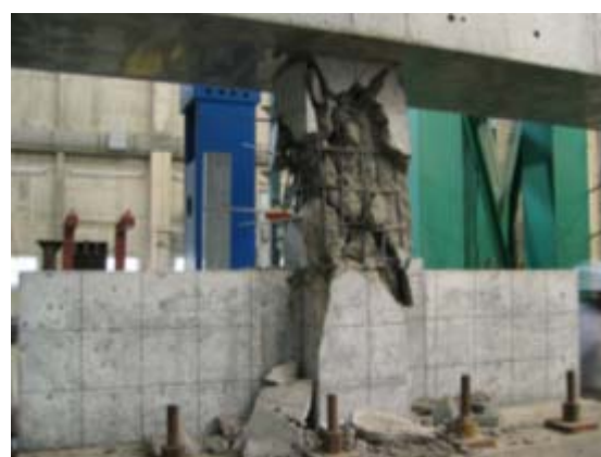
図 3 3 柱 B（せん断先行型柱）破壊状況
