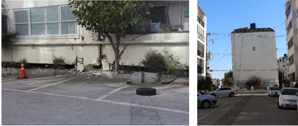
図3 GL部の部材損傷と傾いた建物（DAESUNG APT.）
