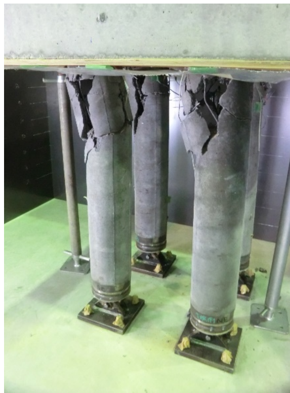
写真2 昨年度の静的加力実験での杭の損傷状況（実験後に砂を撤去）
