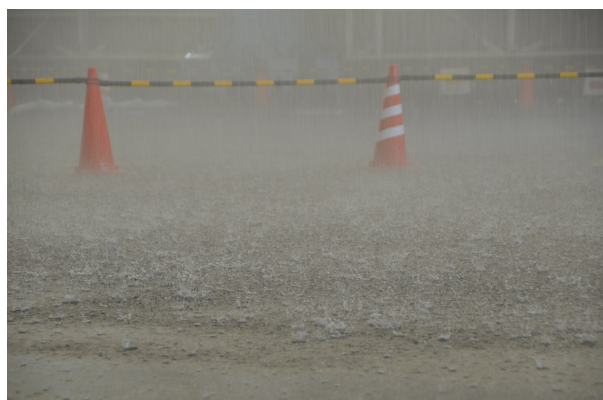
写真2 アスファルトへの降雨
