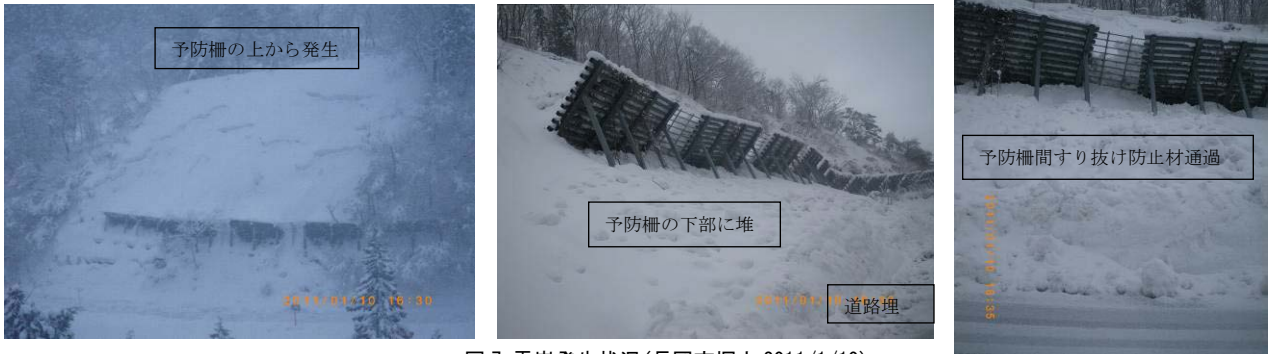
図7 雪崩発生状況(長岡市塚山 2011/1/10)
