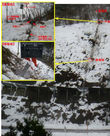
図8 グライドメーター設置状況(長岡市塚山) (県道柏崎小国線(新潟県設置、株興和製))
