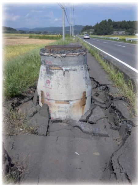
3.11 東北地方太平洋沖地震 による、液状化のために浮き 上がったマンホール (茨城県常陸太田市)
