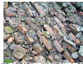
崩壊した家屋の壁のレンガ(アジア防災センター提供)
