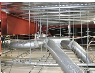
天井内部の設備機器
