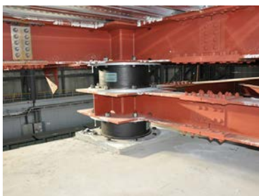
中間層の積層ゴム
