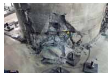
写真-2 破壊した鉄筋コンクリート
