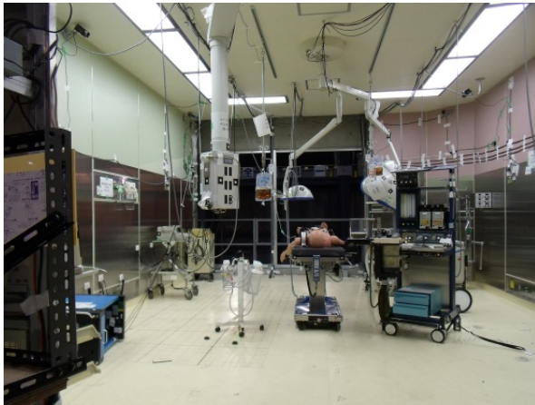
(a) 免震構造内の手術室
