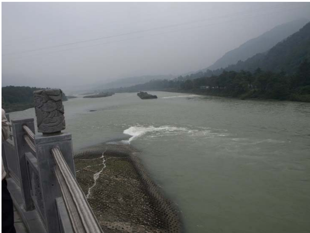
写真4 都江堰の被害（白い筋が被害を受けて補修した跡）
