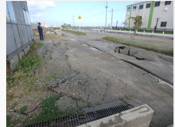
液状化により生じた歩道の陥没。空洞化が懸念される。
