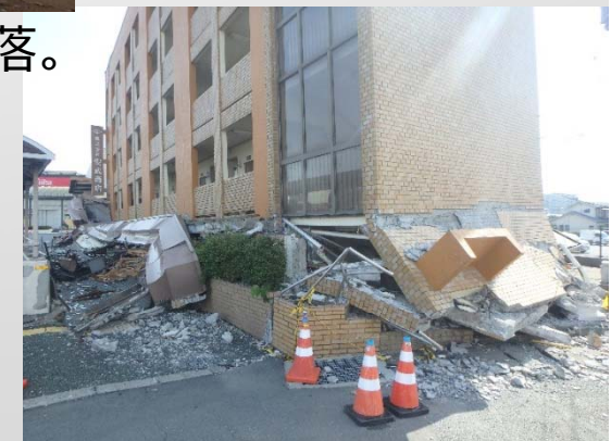
RC建物の1階が倒壊。
