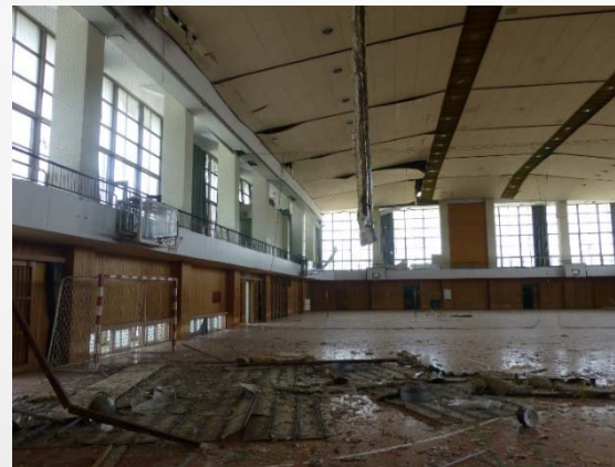
体育館の大規模天井脱落。
