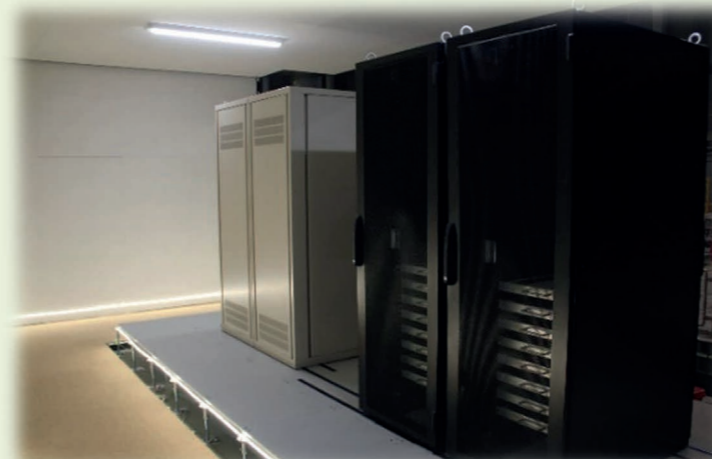
サーバールーム
