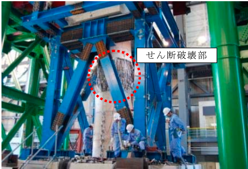
写真 2 : 破壊した鉄筋コンクリート橋脚全景
