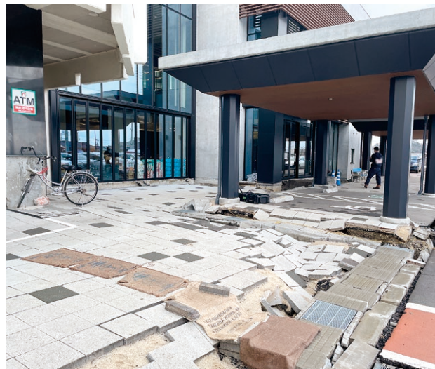
図1 輪島市役所正面玄関前(2024年1月・筆者撮影)
