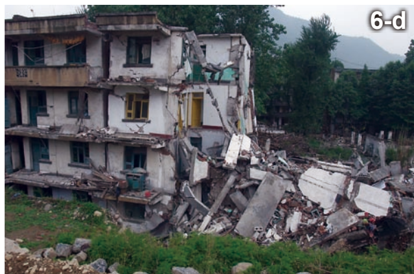
写真6 小魚洞鎮断層近傍の被害状況。
