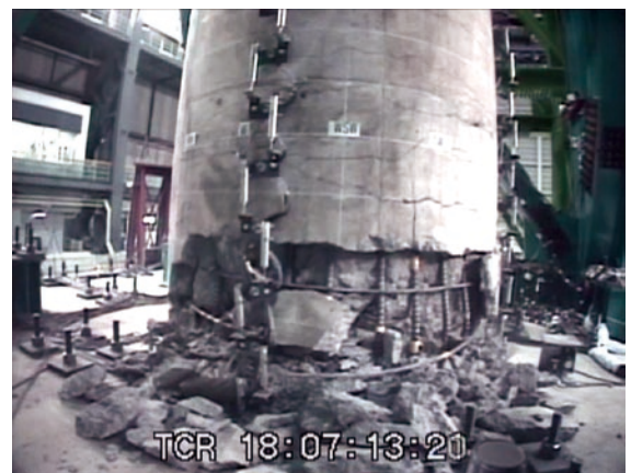
写真2 1970年代建設の橋脚（兵庫県南部地震程度の揺れの後）。橋脚最下部で大きな破壊が発生している。
