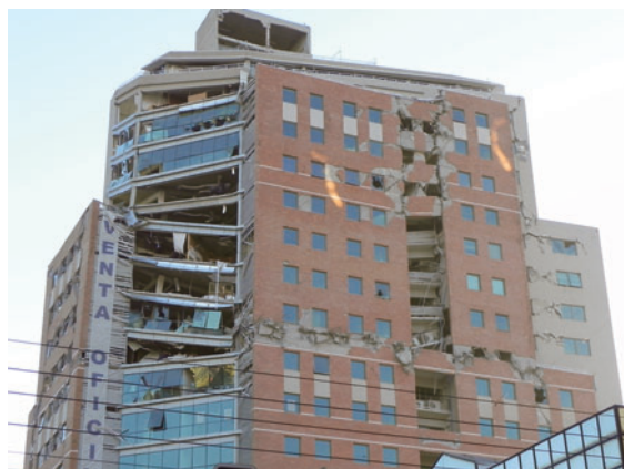
図3 2010年チリ地震による建物の被害
