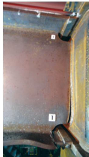
写真2 JR鷹取波で下端フランジが破断した柱(右側)と梁(左側)の接合部
