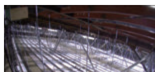
図3 仙台波100%での耐震天井斜め部材が変形したが脱落はなかった
