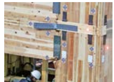
写真2 E棟小型パネル接合部の損傷 状況 (JMA神戸波加振後)
