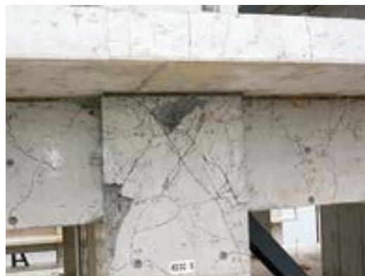
図4 耐震実験時の構造物損傷（柱梁接合部）
