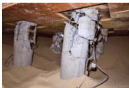
写真2 加振により損傷した杭
