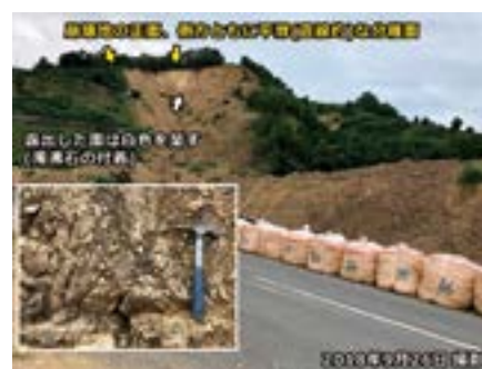
写真1 愛媛県宇和島市白浦地区で発生した深層崩壊。
