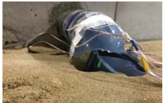
図2 排水管の損傷
