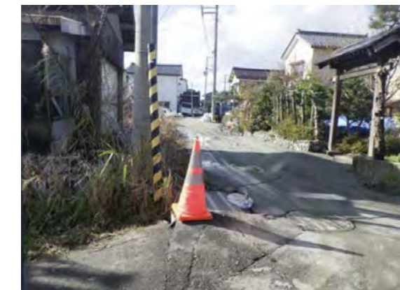
液状化による隆起と陥没 新潟市西区（調査速報より）
