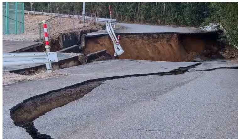
石川高専キャンパス内の地滑りと道路の地割れ
