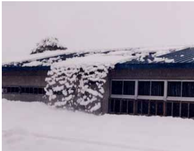
図5 突然起こる屋根雪崩
