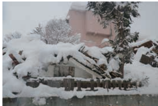
図4 空き家の倒壊(新潟県1月15日)
