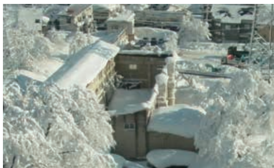
図1 湯沢発電所の建物の屋根崩落
