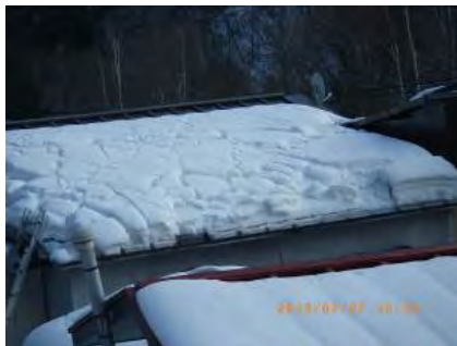
図5 屋根雪の崩落
