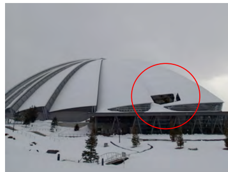
図1 損傷した幕構造物（○印）
