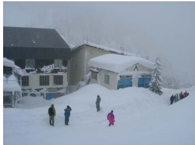
図1 雪崩で被害をうけた旅館。ブルーシートで覆われている部分の窓が損壊した。
