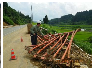
図3 表層崩壊、吊柵崩落(十日町市天池)
