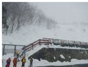
国土交通省山形河川国道事務所からの依頼で応急対策アドバイス
