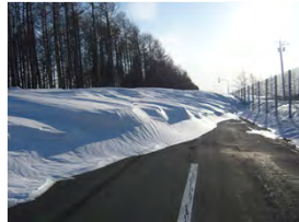
吹きだまりで埋まった道路(養老牛地区)
