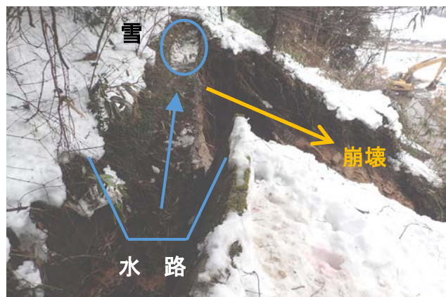
図 3 水路内部と崩壊の状況 (水路上流側から撮影)
