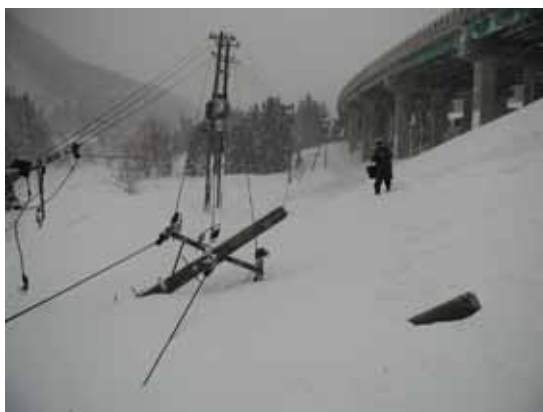
図 2 雪崩の衝撃により倒壊した電柱
