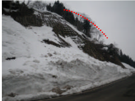
写真 24 一週間後の状況 法枠工からの 雪崩発生痕跡(新潟県十日町市)
