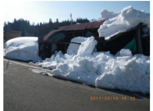
写真 27 地震によって傾いた建物、屋根雪が載った状態(長野県栄村)
