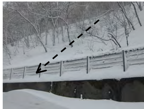
図6 予防柵をすり抜けた雪崩 (破線矢印)
