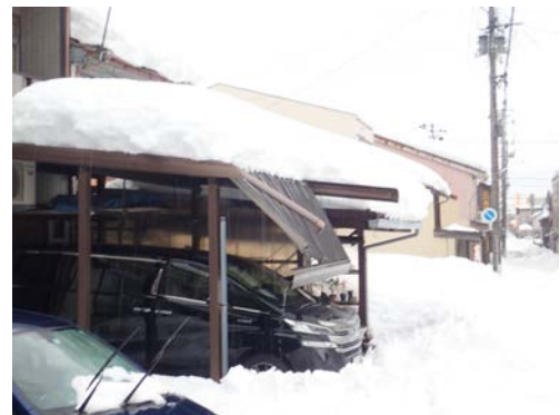
図3 一部損壊したカーポートの写真
