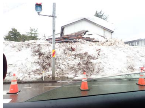
図2 一部損壊した古民家の写真
