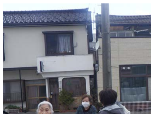
写真6 液状化による家の傾き 糸魚川市中央区
