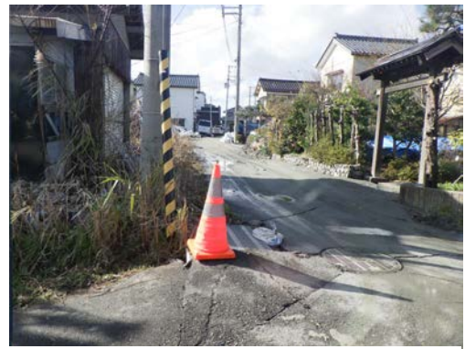
写真 1 液状化による隆起と陥没 新潟市西区
