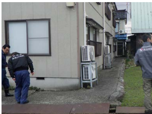
写真5 液状化による地盤の起伏 糸魚川市中央区
