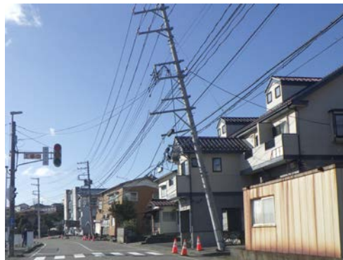
写真4 傾いた電柱 新潟市西区
