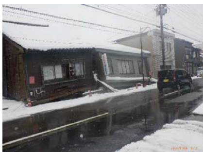
写真 1 1 階部分の層破壊 氷見市
