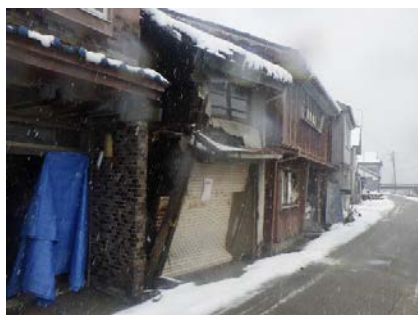
写真 4 応急危険度調査で危険と判定された建物 氷見市
