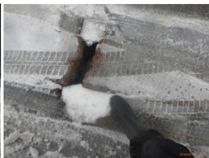
写真 3 消パイ接合部の破断 氷見市
