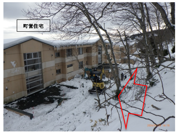
写真6 礼文地区 被災した町営住宅。1階部分は完全に埋没
