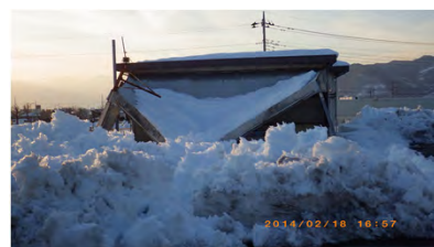
山梨県笛吹市 国道20号線沿 雪の重みで潰れた屋根
