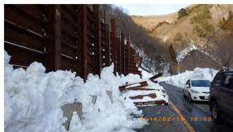
山梨県 300号線沿 本栖湖 雪崩で破壊された道路脇の柵
