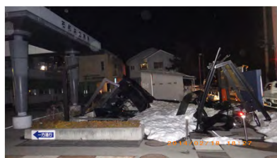
山梨県笛吹市石和町 雪の重みで潰れた病院玄関前駐輪場
