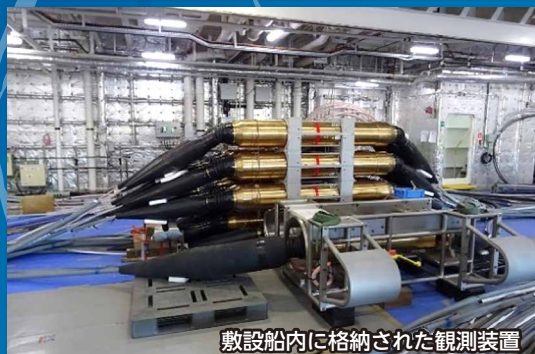
敷設船内のケーブルタンクの様子
